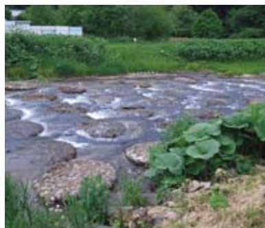
北海道新得町を流れるペンケ新得川に設置された早瀬魚道（おはじき魚道）。
